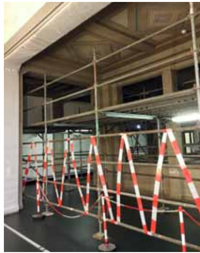
Sicherung im 2. Obergeschoss
