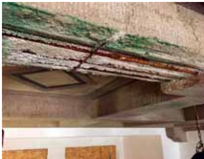
Schaden an der Schmuckdecke
